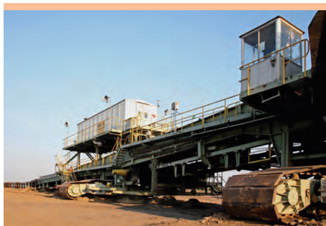
Stacja napędowa przenośników, odkrywka „Drzewce”.
