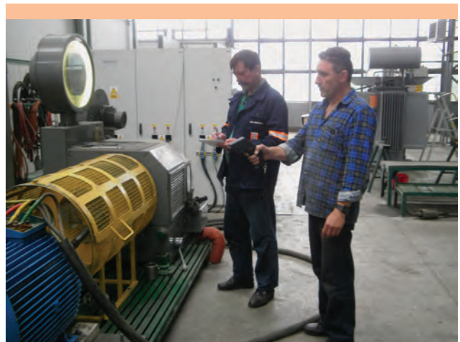
Kontrola pracy silnika na stacji prób oddziału n-4 – Sławomir Kucharski, Krzysztof Paradecki – elektrycy, monterzy aparatury, automatyki i pomiarów.
