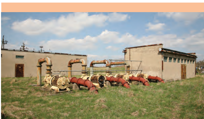
Pompownia wód powierzchniowych w miejscowości Suszewo wykorzystywana do deszczowania. Być może była jedną z przyczyn obniżania się zwierciadła wody w Jeziorze Suszewskim.
