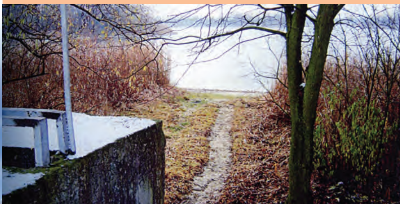
Północny kraniec jeziora Suszewskiego. Dno dwururowego przepustu drogowego, oddzielającego je od jeziora Kownackiego, leży znacznie powyżej poziomu wody w jeziorze.*
