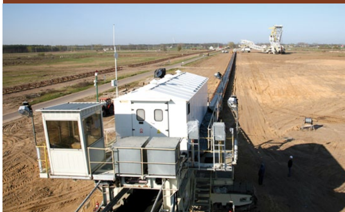
Gotowa stacja napędowa i przenośnik taśmowy, w głębi koparka KWK-1500s.
