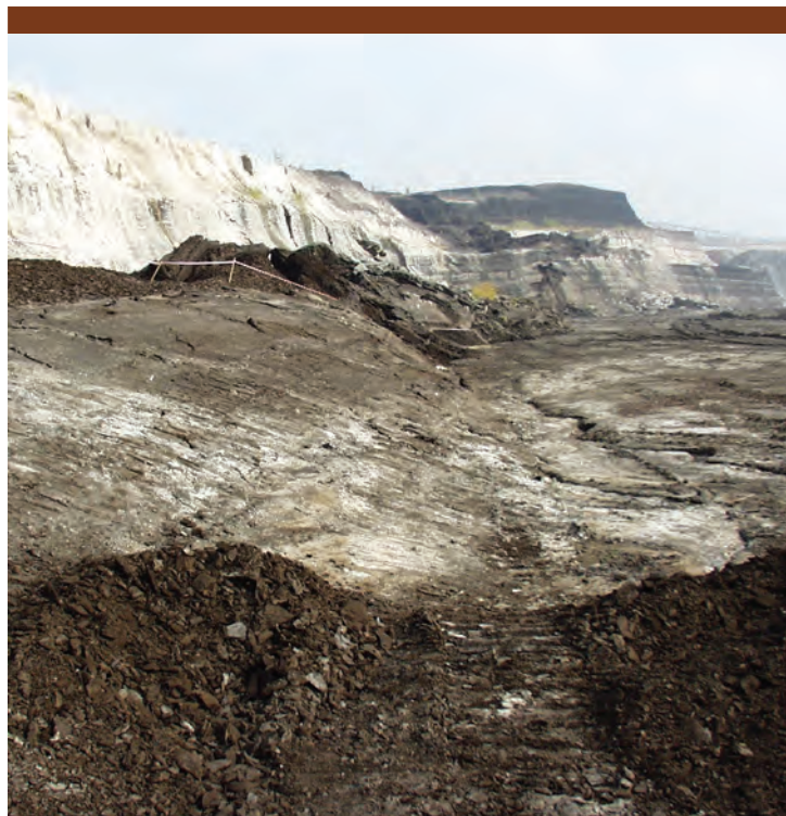
Rys. 5. Osuwisko z 2006 r. Wypiętrzenie i zaciśnięcie rowu na poz. 110.
