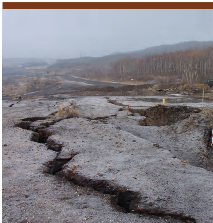
Rys. 7. Osuwisko – deformacje na poz. +180 (stan na 2.01.2008.
