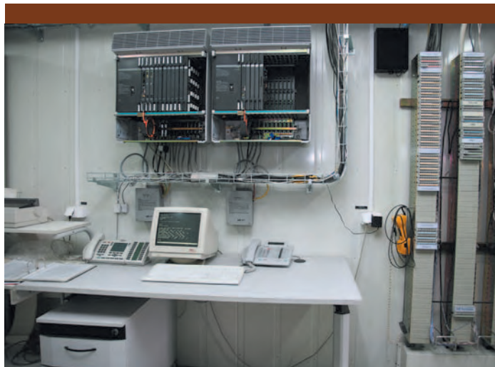
Wnętrze kontenera łączności Odkrywki „Drzewce”.
