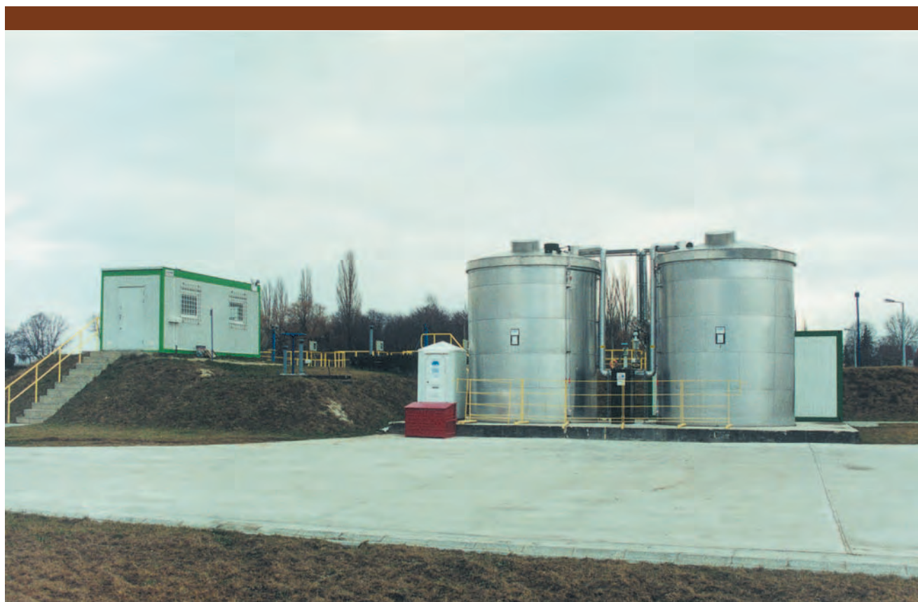
Rys. 4. Dyspozytornia i zbiorniki środków do oczyszczania wód kopalnianych.
