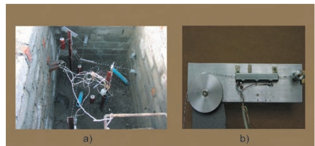
Rys. 6. Zdjęcia komory pomiarowej z czujnikami telemetrycznego systemu pomiarowego.
