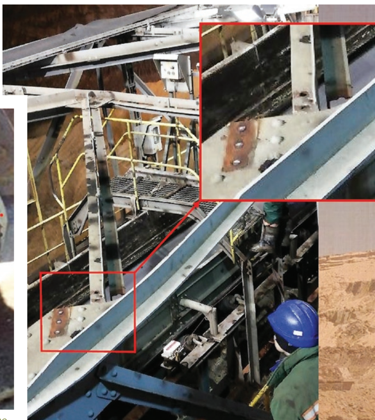
Fot. 9. Uszkodzony pręt na wysięgniku T-1 koparki SchRs 1200/6.
