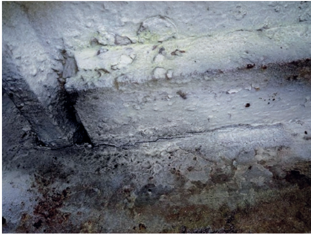
Fot. 19. Badania magnetyczno-proszkowe (MT): pęknięcie na słupie zawieszenia konstrukcji przenośnika T-2 na zwalówarce A 2 RsB 8800/2.
