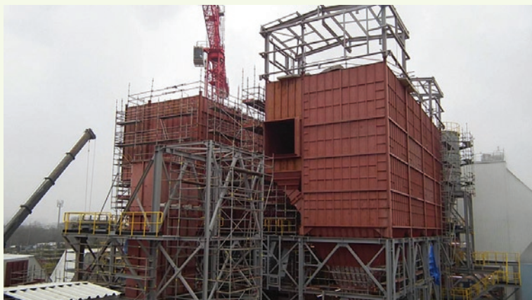
Instalacja odsiarczania spalin, filtry workowe A i B, Pomorzany.
